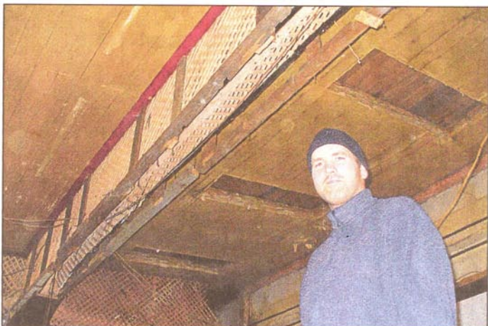
„Die alte Kassettendecke im Hauptraum musste aus hygienischen Gründen herausgerissen werden“, bedauert Ralf Hoffmann. Foto: us
