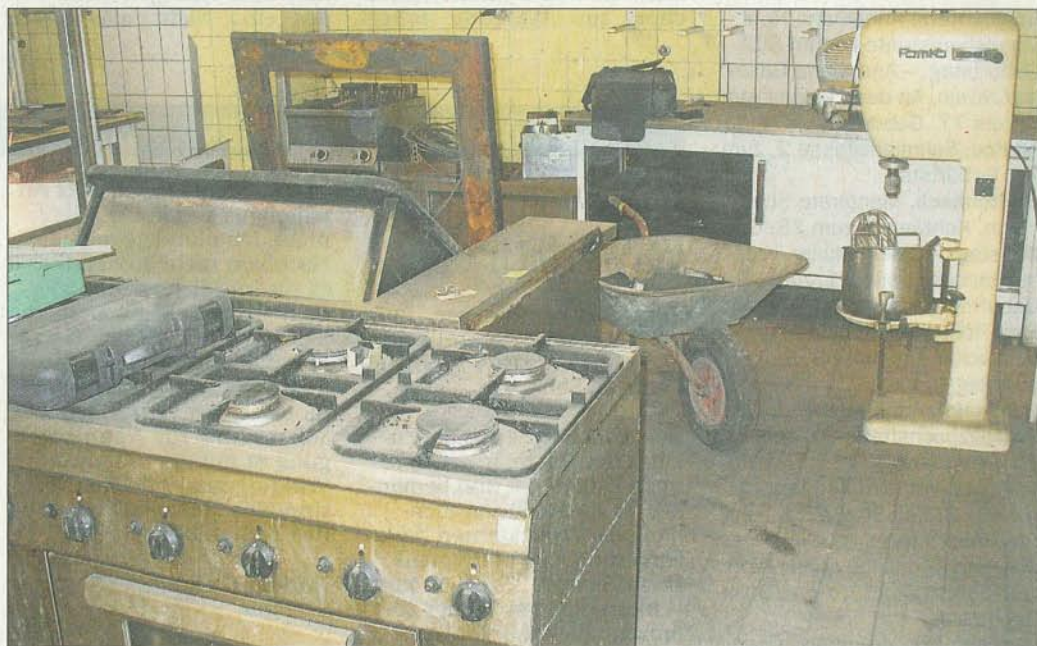
Die alte Küche ist in einem völlig desolaten Zustand. Sie muss grundsanitiert werden.
